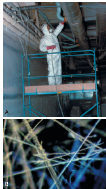
Fig. 2.17 L'isolation par l'amiante est courante dans les constructions et présente un danger lors de la démolition. (A) Des vêtements de protection doivent être portés pour éviter tout contact avec (B) les fibres d'amiante.
